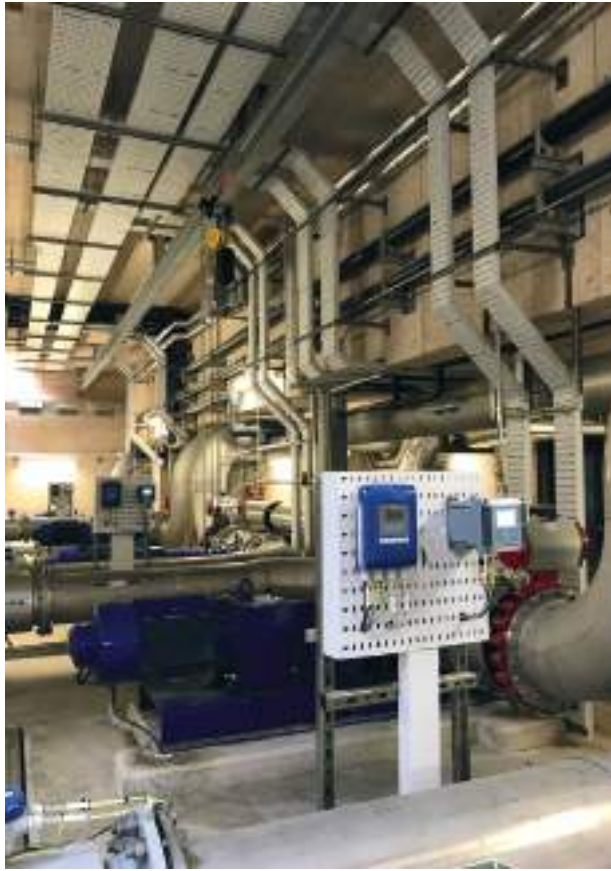
Tratamiento de aguas: EDAR
