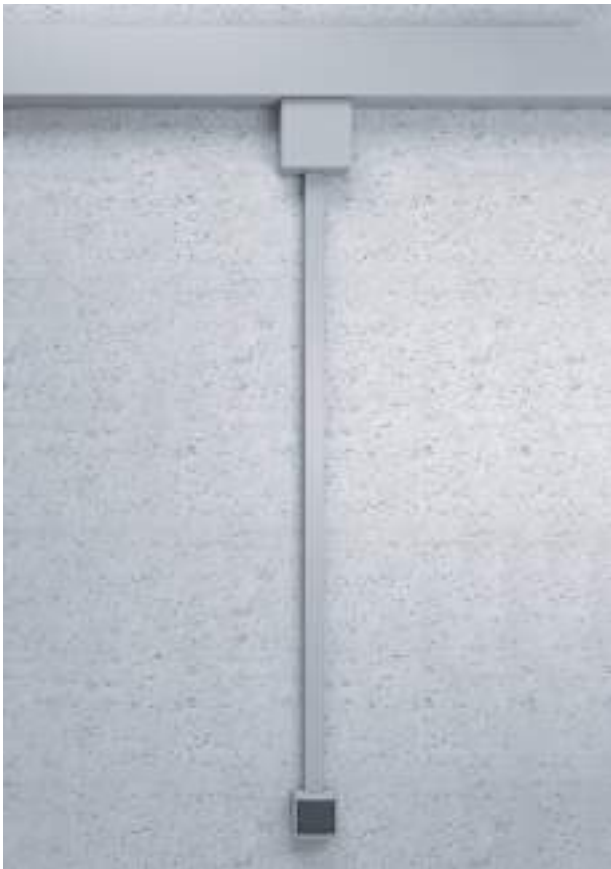
Nave industrial: alimentación de mecanismos
