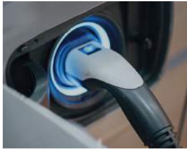
Instalaciones de recarga de vehículos eléctricos
