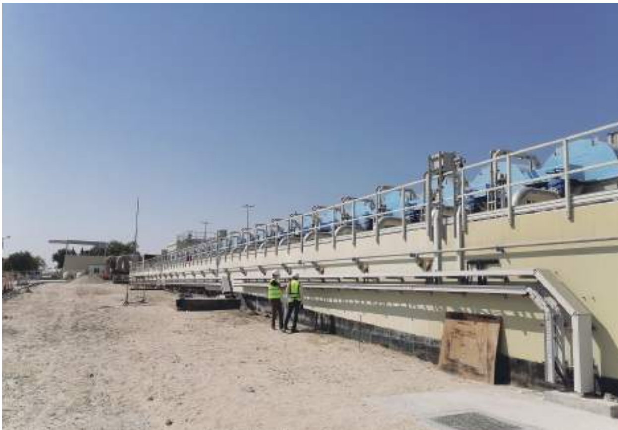
Tratamiento de aguas: EDAR
