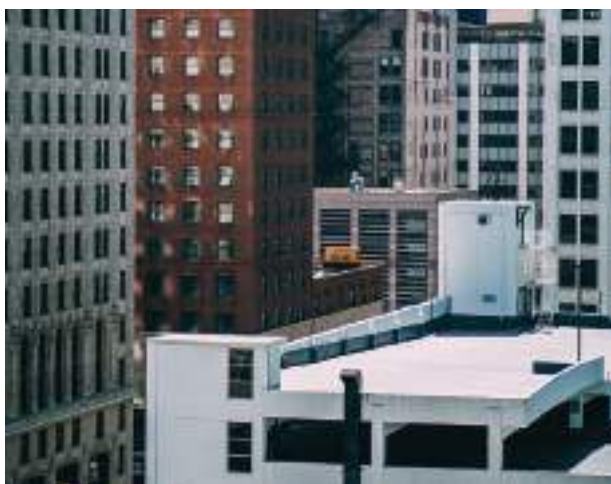
Instalaciones en azoteas
