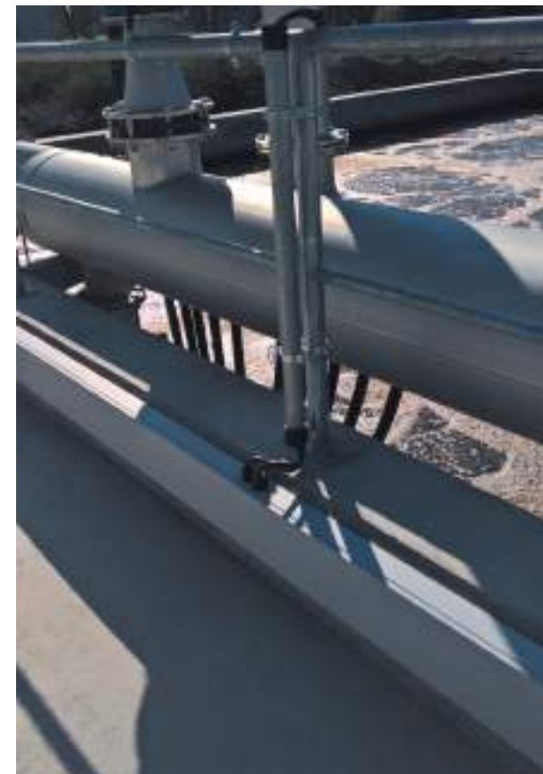
Tratamiento de aguas: EDAR
