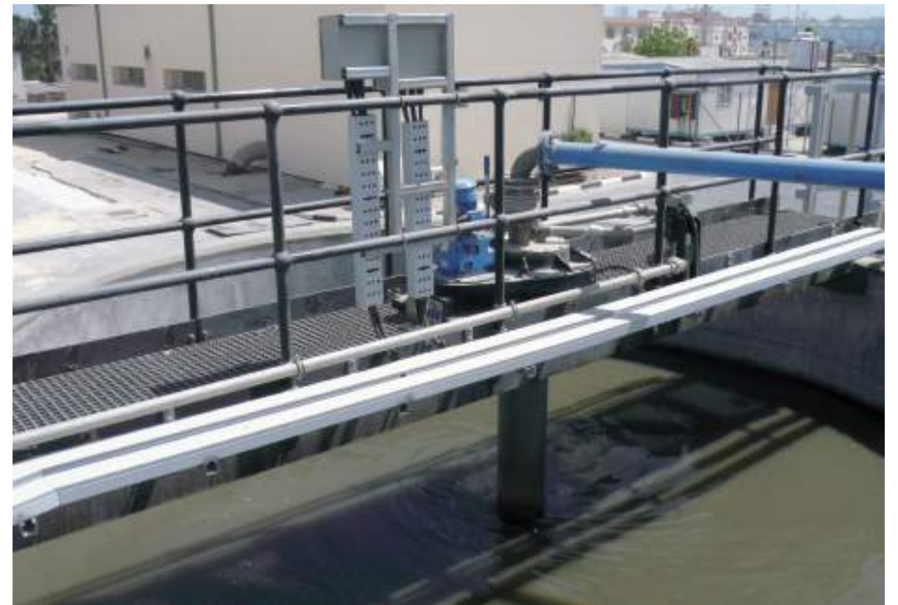
Tratamiento de aguas: EDAR
