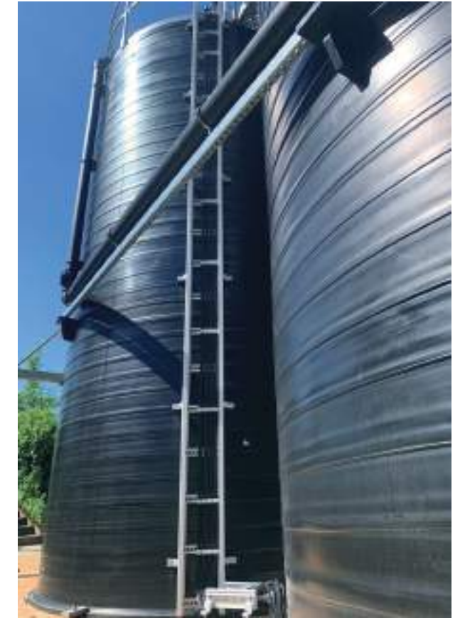
Tratamiento de aguas: EDAR
